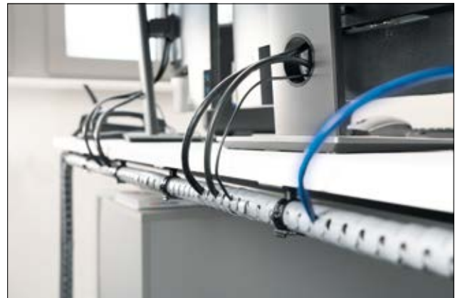
Helawrap - zarządzanie kablami w przestrzeni biurowej.
